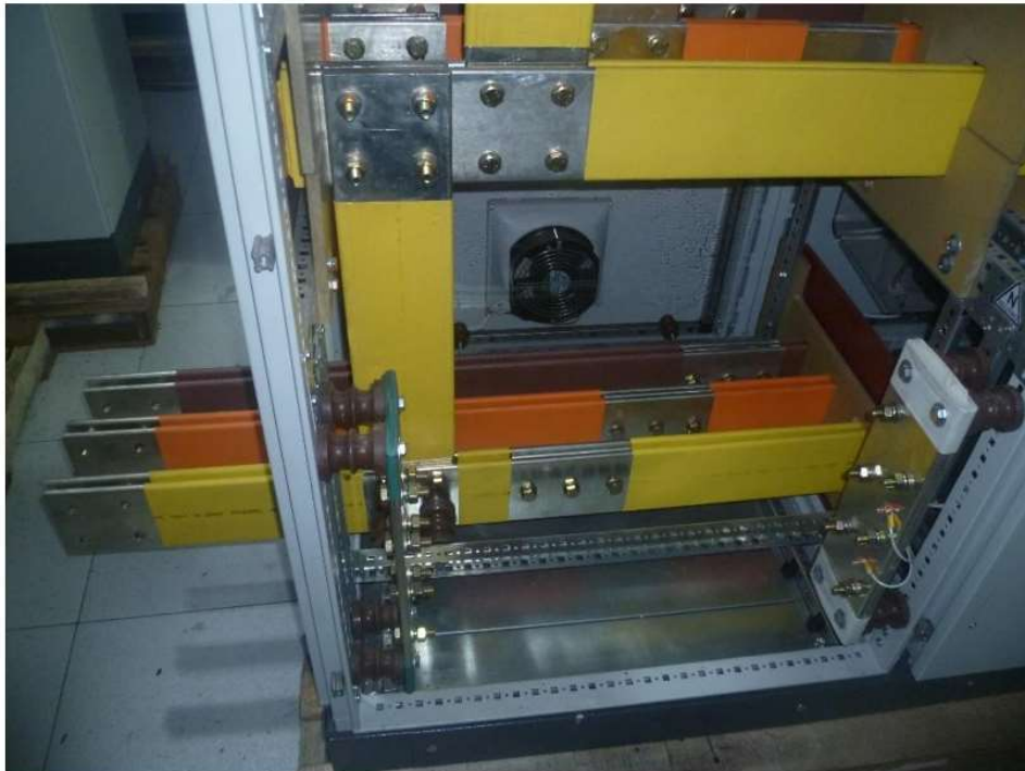
Foto No.4. Vista posterior de barras horizontales de acople para unirse en potencia a tablero de distribución general
