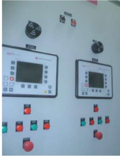
Foto No. 2. Vista frontal de gabinete uno con los mandos en puerta de todo el control de sincronismo.
