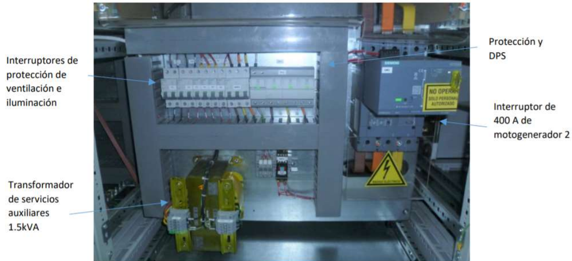
Foto No. 1. Vista frontal de gabinete uno con los mandos en puerta de todo el control de sincronismo.
